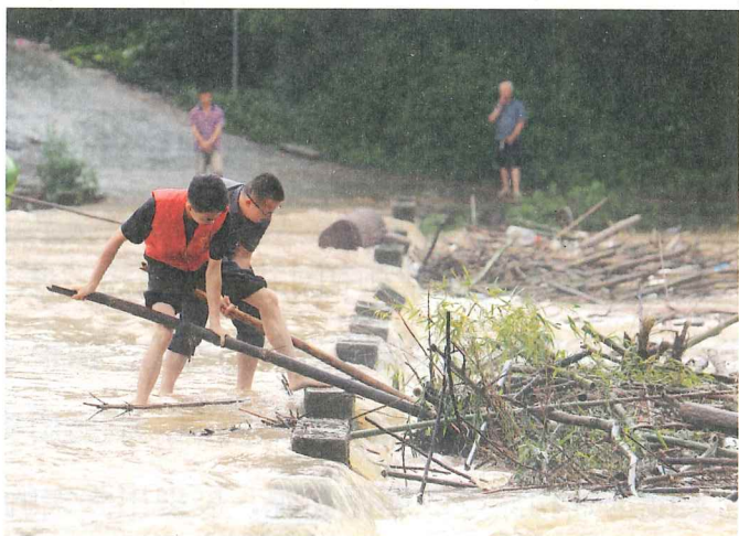
受今年第十号台风“美莎克”影响，广西柳州市融安县出现强降雨过程，洪水漫过大将镇逢村屯桥面，竹木等杂物大量卡在桥墩，危及桥梁安全。图为2026年7月6日，在逢村屯，党员干部冒雨清理大桥上的杂物。 谭克兴/摄
